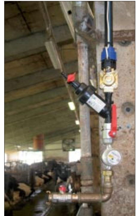
Anschlusspunkt im Stall (von unten): Zuleitung (hier mit Schlauchanschluss), Wasseruhr, Kugelhahn, Filter, Ventil und Leitung zu den Tropfrohren über den Tieren am Fressgang.
